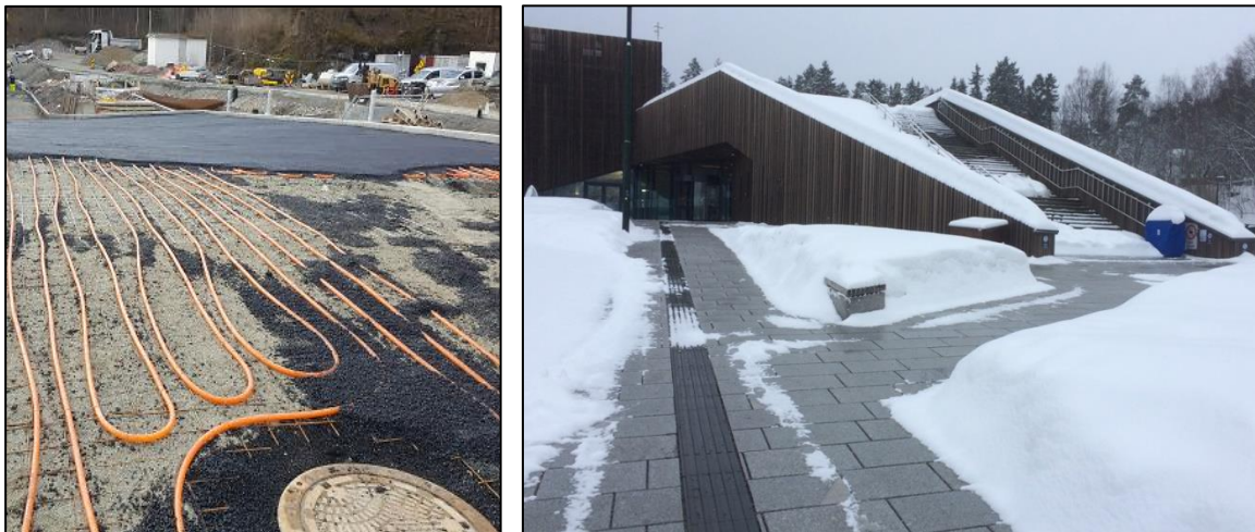
Figur 24. Solfangere under asfalten benyttes til snøsmelting ved Holmen svømmehall (2017)
