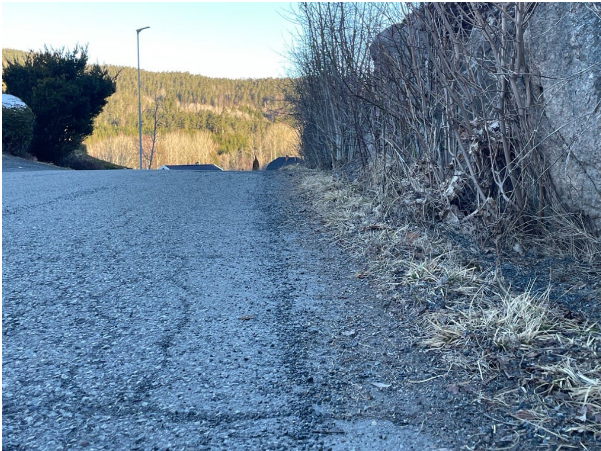
Figur 9 Det er lagt seg en kant av strøgrus og gress, som hindrer vannet å renne ut. Asfalten degraderes. Foto: Roy Rikardsen
