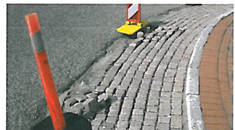
Gatesteinsbelegg med mangelfull låsing av ytterkant.
