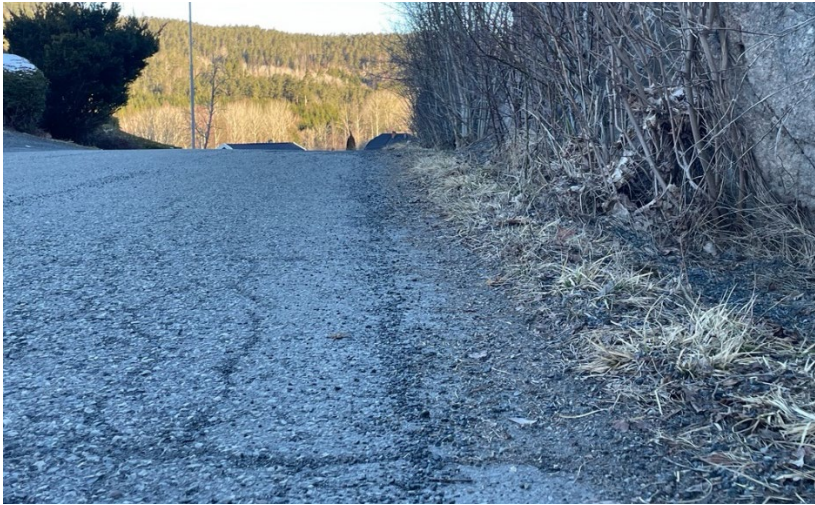
Figur 13 Manglende grøft, med konsekvens at vannet blir værende på veien. Foto: Roy Rikardsen
